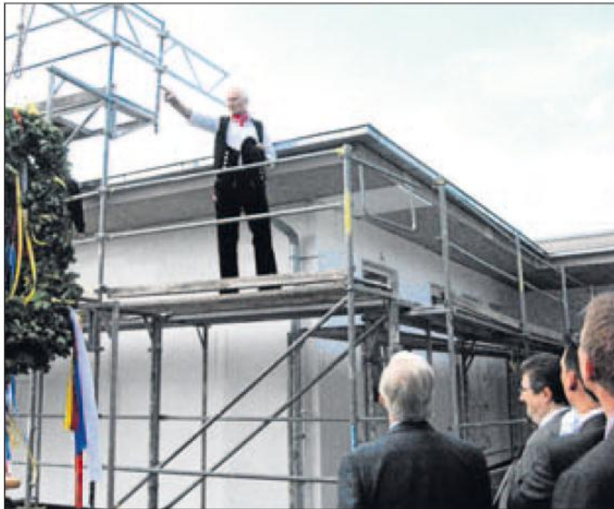
Richtfest für Gifhorns ersten Betriebskindergarten „Robin HuD“ an der August-Horch-Straße. Foto: Alisch
